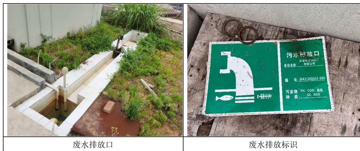
图 4.2-4 废水排放口及标识标牌
