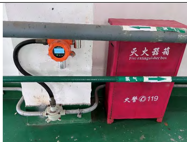
装置区泄漏报警装置
